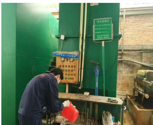
图21: WS-17052 废水排放口 (处理后)
