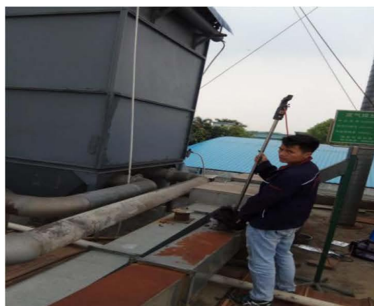
图8: FQ4-17052 热固化废气采样口1（处理前1）
