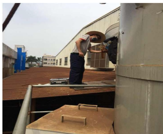
图16: FQ5-17502 焊接废气采样口（处理前）
