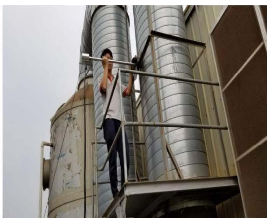
图17: FQ5-17502 焊接废气排放口（处理后）
