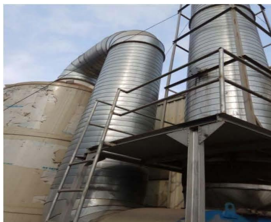
图35：焊接废气处理装置
