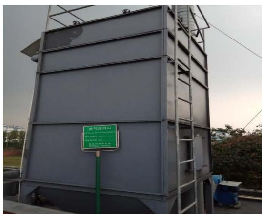
图31：喷粉废气处理装置
