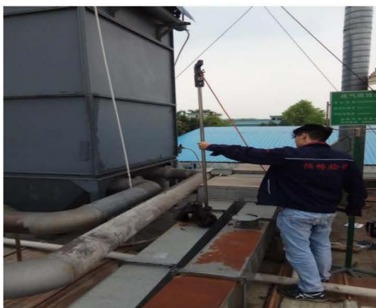
图9: FQ4-17052 热固化废气采样口2（处理前2）
