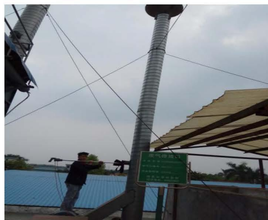
图10: FQ4-17052 热固化废气排放口（处理后）
