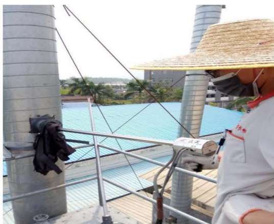
图13: FQ3-17052 炉窑废气排放口（处理后）
