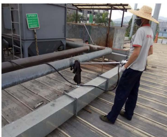
图11: FQ3-17052 炉窑废气采样口1（处理前1）
