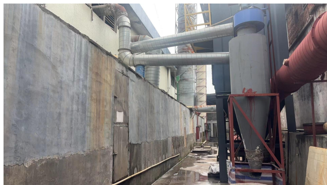
抛丸、制壳、振壳、打磨废气治理设施 DA004、DA005、DA006
