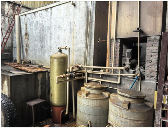
生产废水处理设施
